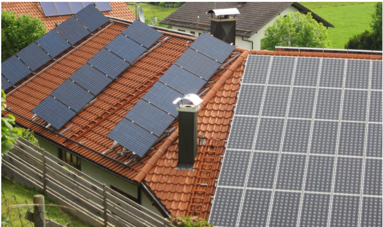
Abbildung 11: Solarthermie und Photovoltaik auf einem Dach. (Foto: Energie- und Umweltzentrum Allgäu).
